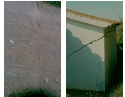
Fig. 6.- Rotura en 1981 del terreno y de una vivienda en Monte de los Almendros (Salobreña).
