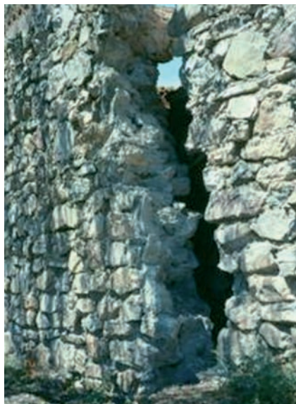
Fig. 8.- Grietas de tracción y rotura del muro principal en El Montañés (Almuñécar) en 1991.
