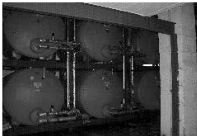
Figura 12 : Nuevos depósitos de acs del Hospital Infanta Elena
