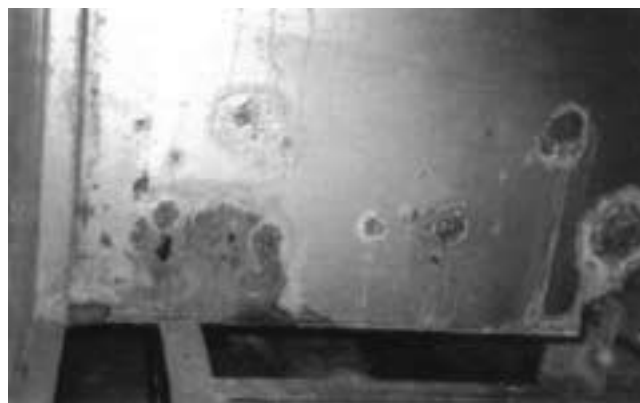
Figura 5 : Efectos de la corrosión en el exterior de una torre
