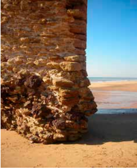
Figura 4. Arranque, muy deteriorado, de uno de los contrafuertes o puntas de diamante que reforzaban la zapata de la torre (fotografía de los autores).
